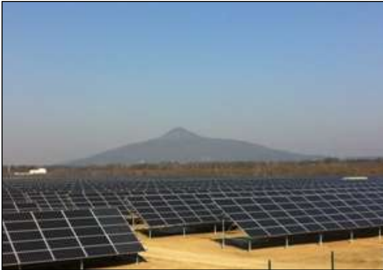
Obrázek 1: Fotovoltaická elektrárna v Mimoní
